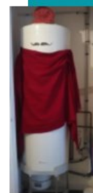
Isolez ballon et tuyaux, gardez vos kilowattheures au chaud !
